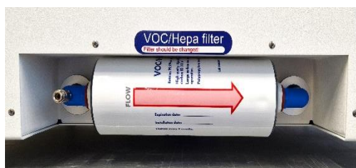
Figura 12.3 Filtro COV/HEPA instalado corretamente
